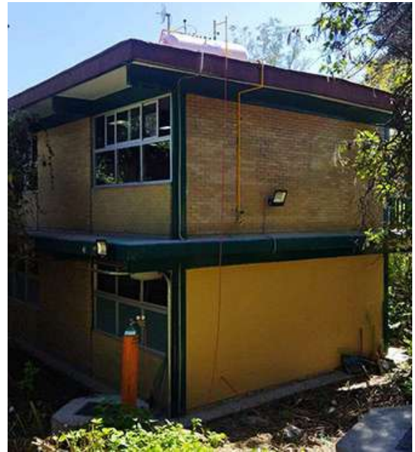
■ CUIDADO correctivo a instalación de gas.
