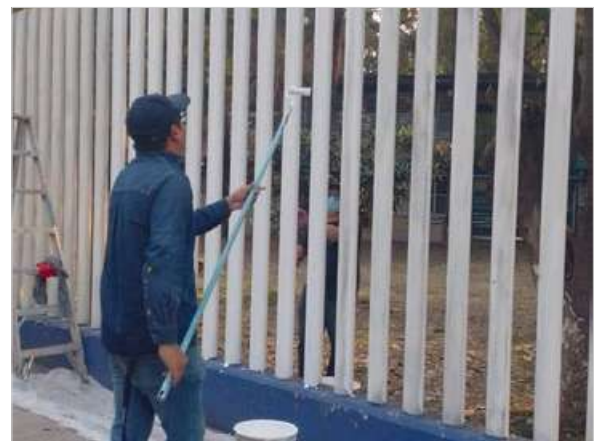
■ PINTURA en rejas de estacionamientos.
