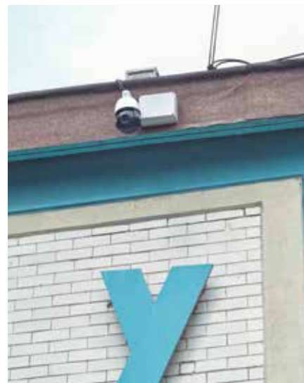
Cámara de seguridad en el edificio "Y".
