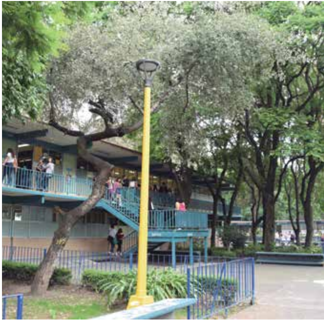
Luminaria punta de poste en andador, entre edificios "P" y "Q".
