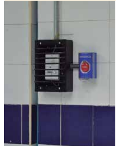
Interfón y botón de emergencia en el edificio "R"
